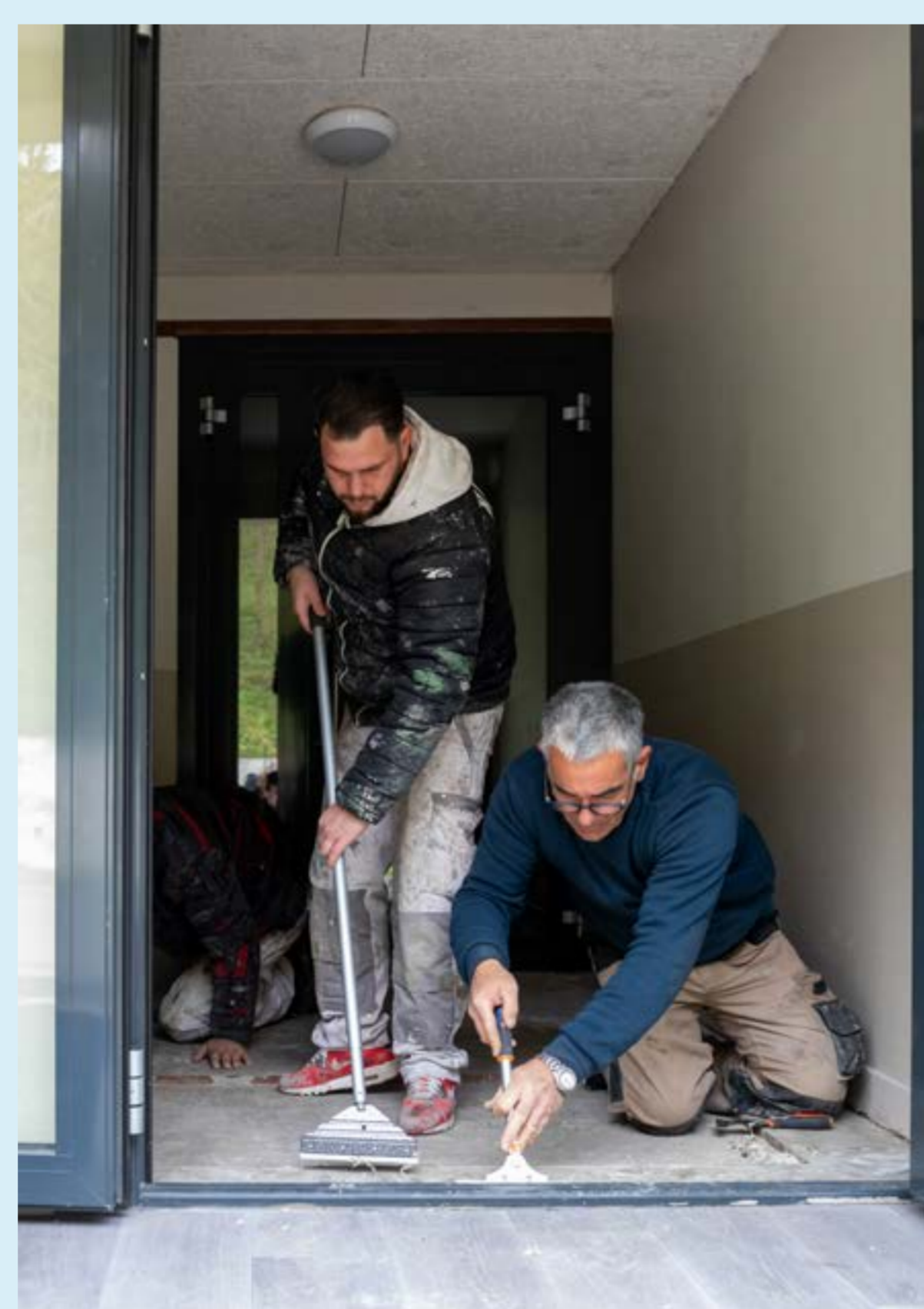
Chantier d'insertion de rénovation de bâtiments dans le quartier La Moustey à Saint-Pierre-Mont pour le compte du bailleur social XL Habitat. Les chantiers formations proposés par l'association Les Compagnons bâtisseurs de Nouvelle-Aquitaine (CBNA) permettent aux personnes éloignées de l'emploi de se qualifier et de développer des compétences dans les métiers du bâtiment.
