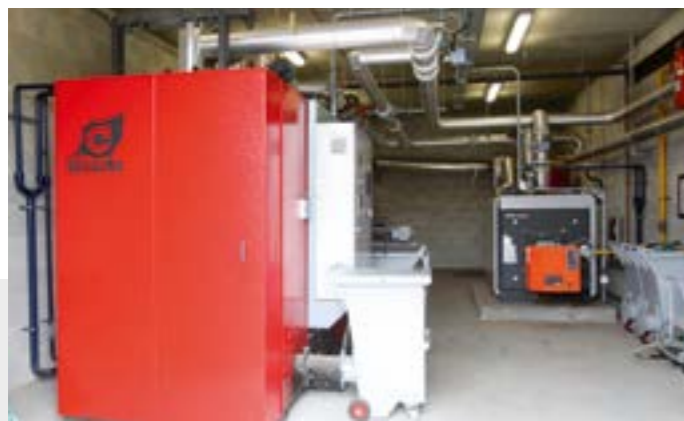
Chaufferie bois - collège de Biscarrosse
