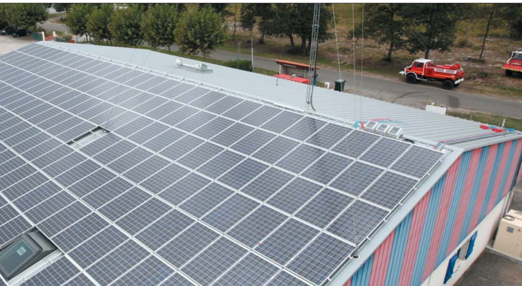
Panneaux photovoltaïques sur la toiture de la caserne des pompiers de Saint-Vincent-de-Tyrosse
